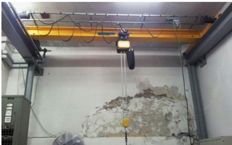
5 Tonnen Brückenkran mit Kranbahnen auf Stützen
