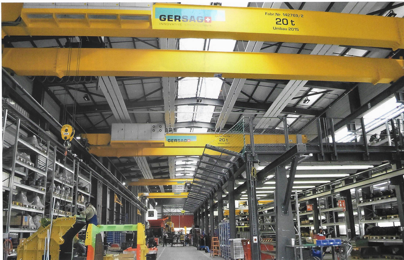
Arbeitsplätze auf der ersten und zweiten Ebene sowie die Übergabestelle können einfach angefahren werden.
